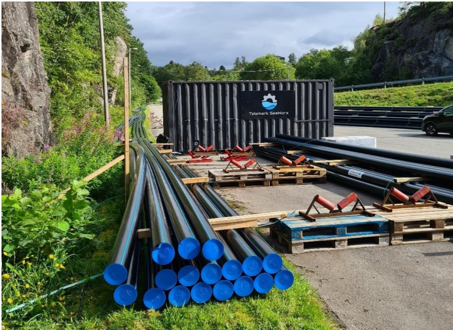
Figur 30: Rigg for sveising av nye PE-rør til sjøleidning mellom Mollandseide og Duesundøy.
