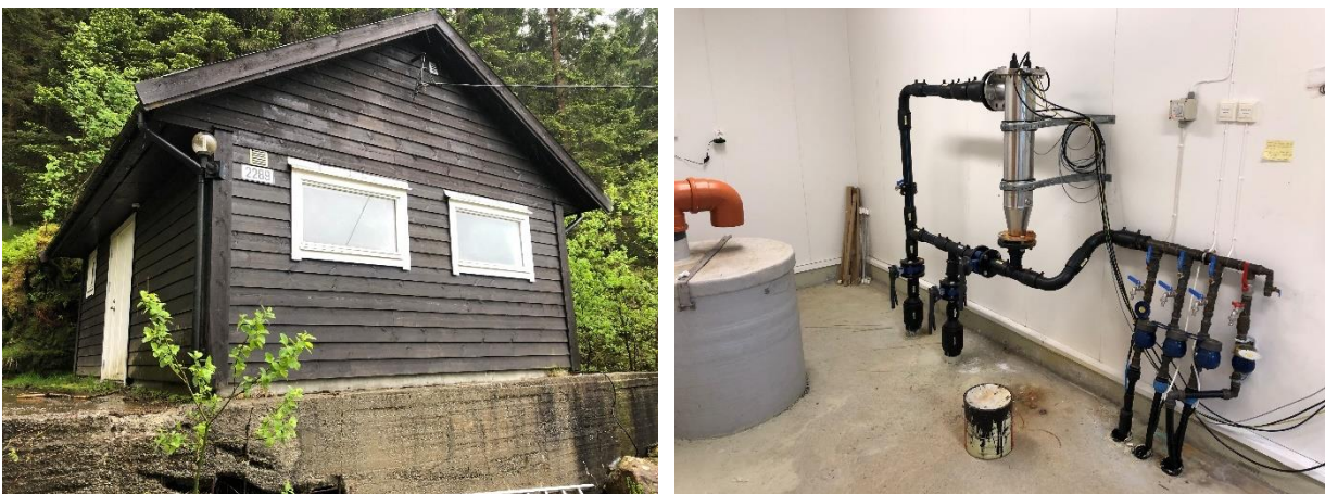
Figur 14: Vassbehandlingsanlegg på Haugsvær, utvendig og innvendig
