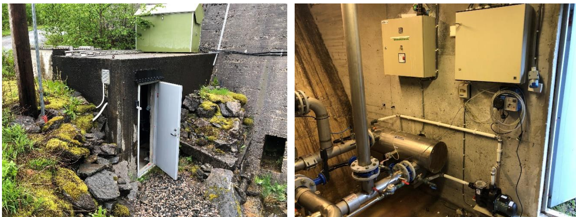
Figur 12: Vassbehandlingsanlegg og UV-aggregat for Matre vassverk
