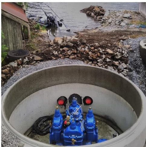
Figur 10: Ny vannkum ved landtak av sjøleidning på Mollandseidet
