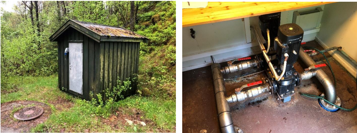
Figur 9: Pumpestasjon for trykkauke ved innkøyringa til Molland, utvendig og innvendig
