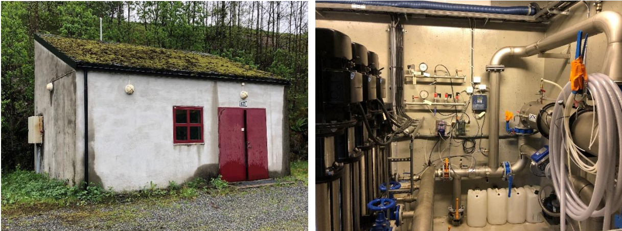
Figur 6: Andvik vassbehandlingsanlegg (bygning), samt UV-aggregat for desinfeksjon (innvendig til høgre) og pumper for trykkauking (innvendig til venstre).
