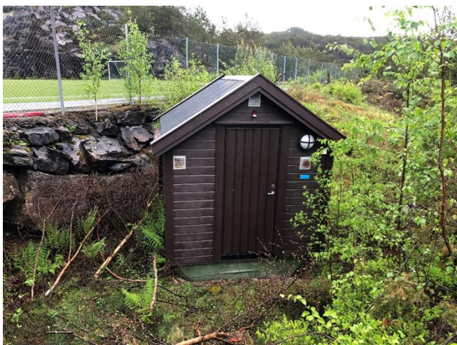
Figur 24: Avlaupspumpestasjon ved idrettsbana på Hosteland
