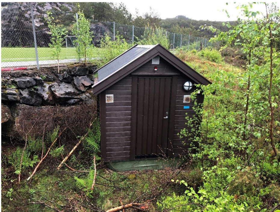
Figur 20: Eksisterande avlauspumpestasjon ved idrettsplassen på Hosteland.
